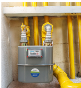
Cabines de medidores
